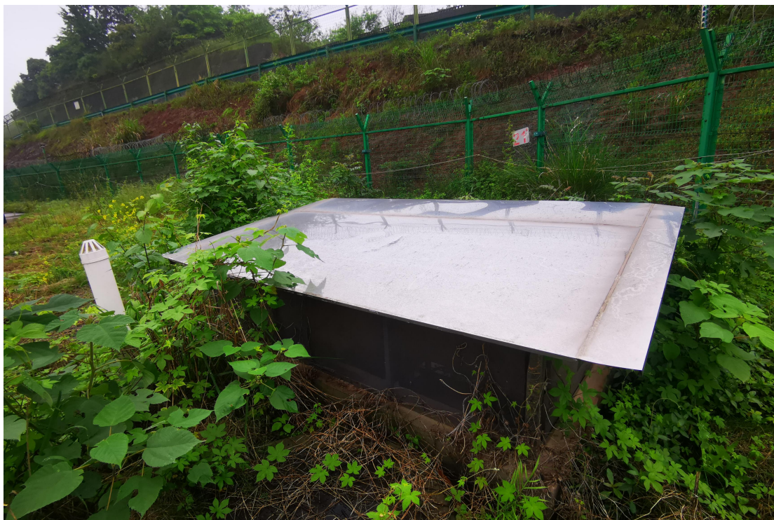
图 4.1-4 第二跑道北侧污水处理设施
