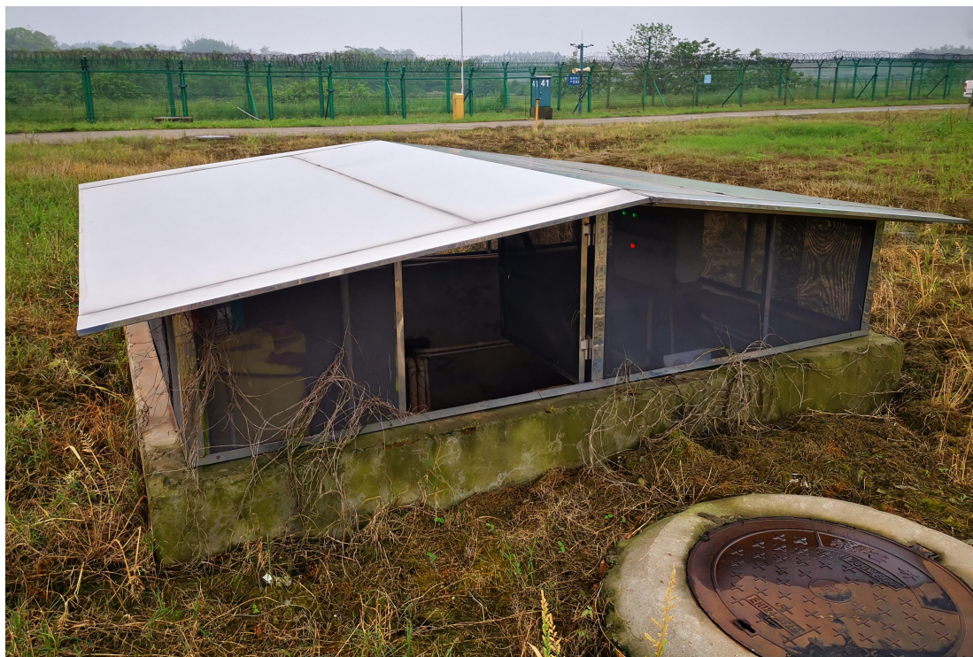
图 4.1-3 第二跑道南侧污水处理设施
